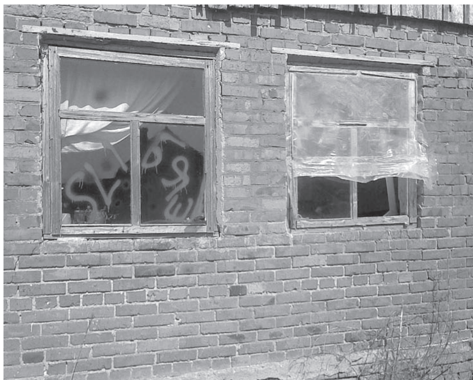
Дом полуразрушен — жить там невозможно
