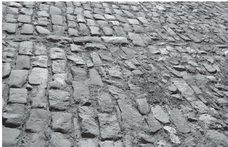
Разбитую брусчатку нужно заменять, а не асфальтировать
