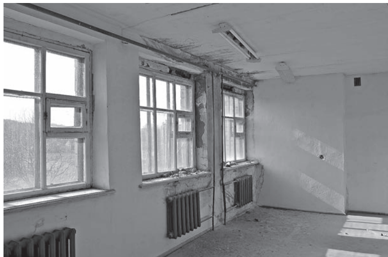
Последствия текущей крыши
